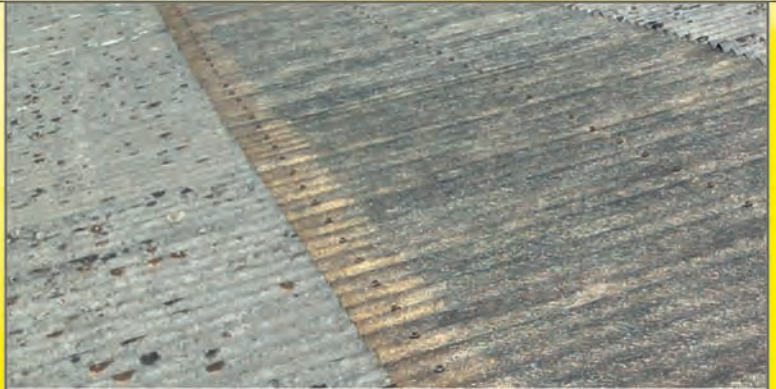
Potenzielle Durchsturzgefahr (PO-GFK-Lichtplatten)
